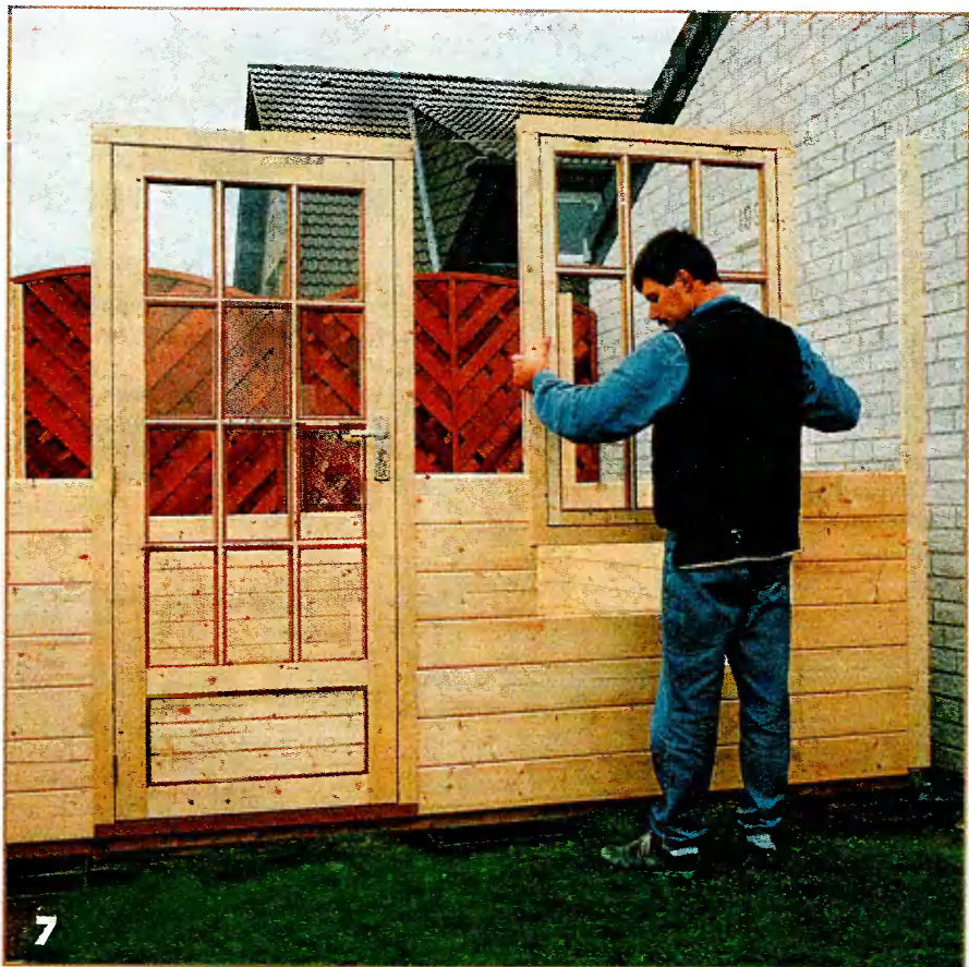
7 Оконный блок вместе с рамой вставляют между укороченными досками обшивки, тщательно выверяя его как в горизонтальной, так и в вертикальных плоскостях.
